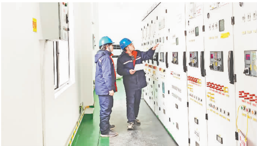
工作人员对即将并网的设备进行最后的试验与检查。
