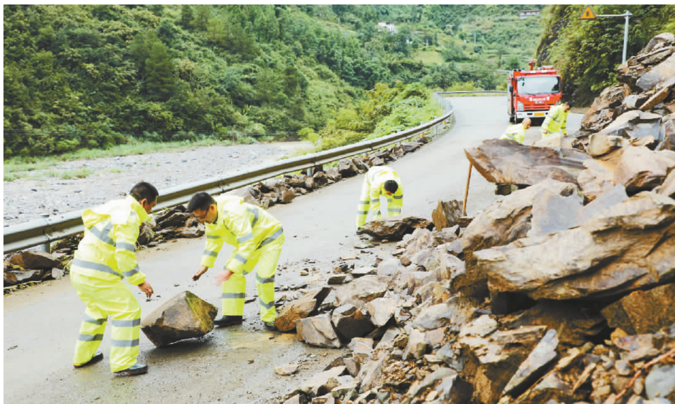
抱龙镇应急抢险人员清理巫(山)建(湖北建始)路庙梁段公路塌方。
