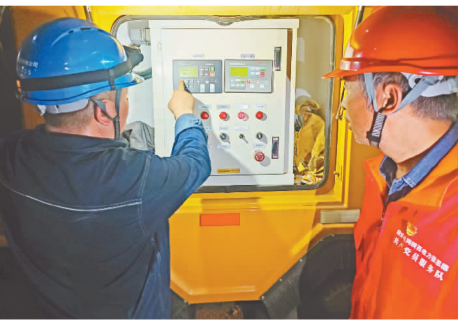
开启输电装置。
