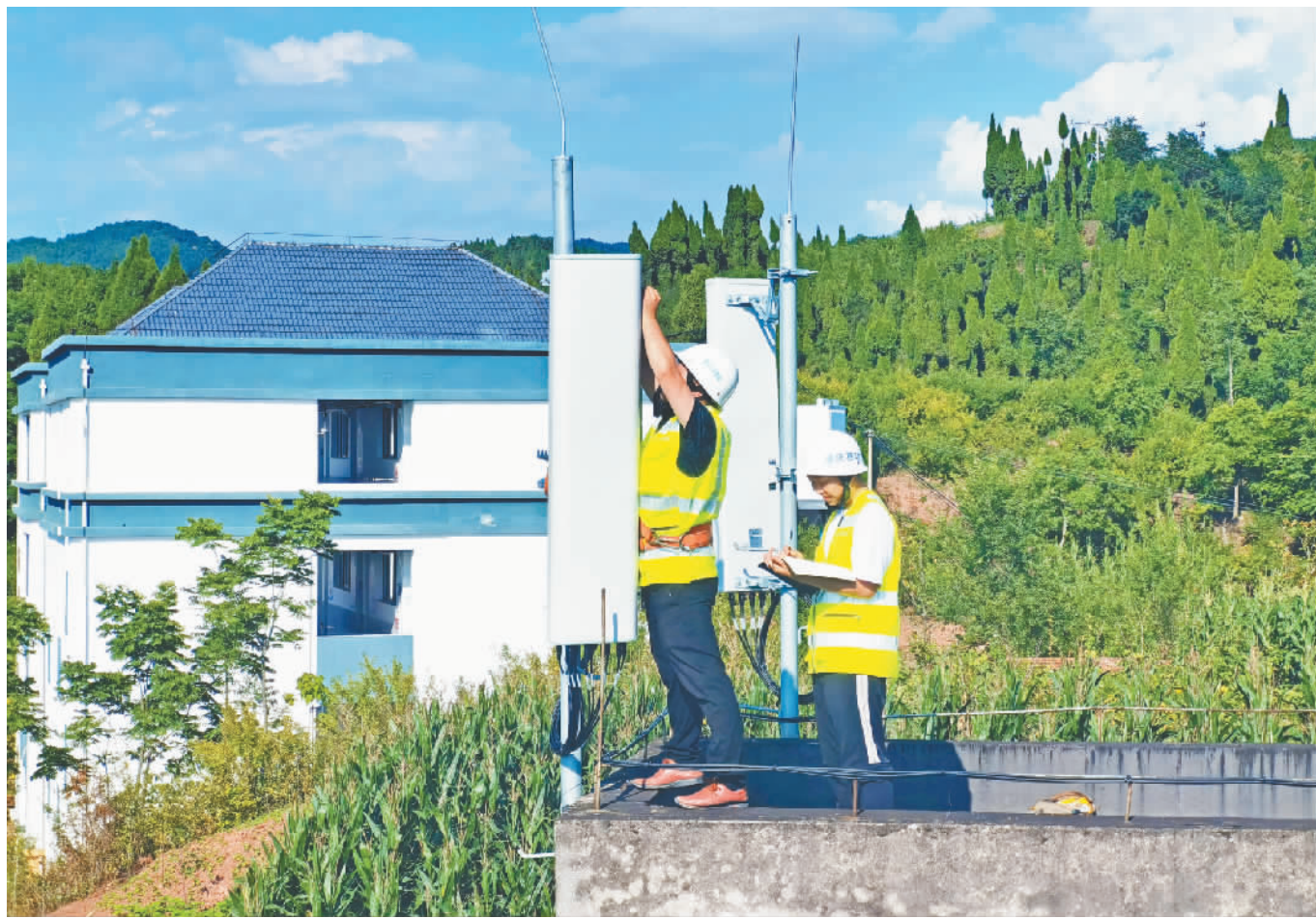
工作人员巡检5G基站设备。
